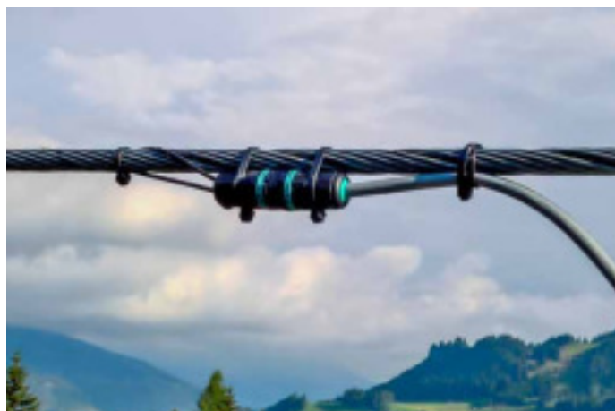
Connection BRUtelecom Data / Anschluss BRUtelecom Data
